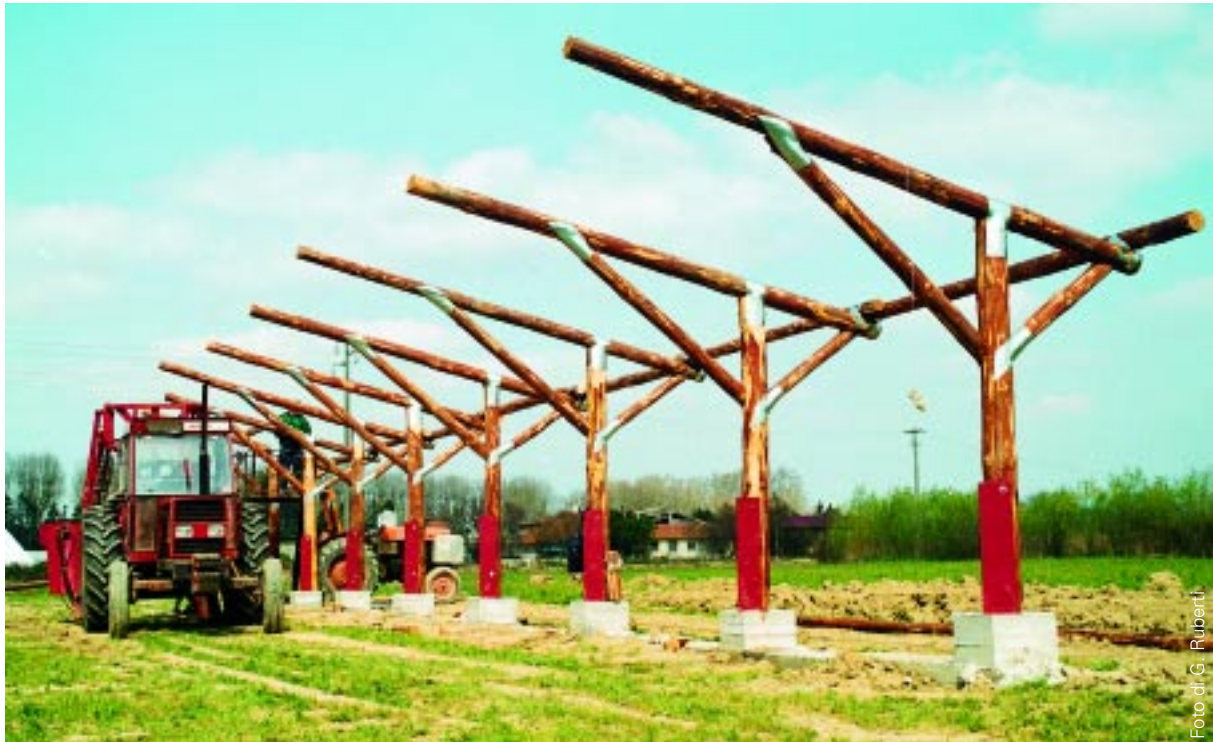
20. Posa in opera della struttura portante in legno tondo della zona di alimentazione con l'ausilio di mezzi meccanici (anno 2000)
